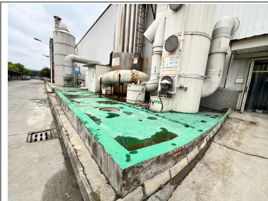
酸碱废气处理设施围堰
